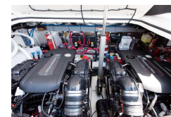
トランサム下のサマーベッド下に収まるエンジンルームには、2基の 8気筒 5.3リットルの進歩的ガソリンエンジン、VOLVO PENTA V8 300が搭載する。コンパクトかつ軽量、高い加速力を発揮するハイパフォーマンスエンジン。
